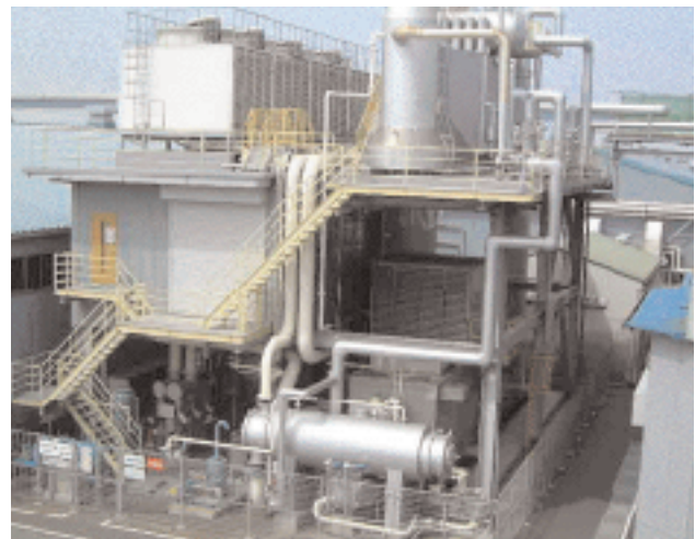
川崎工場のコージェネ設備
