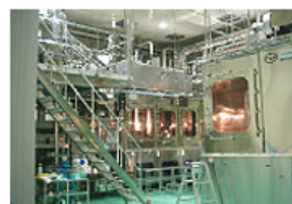
NSシステム充填設備
